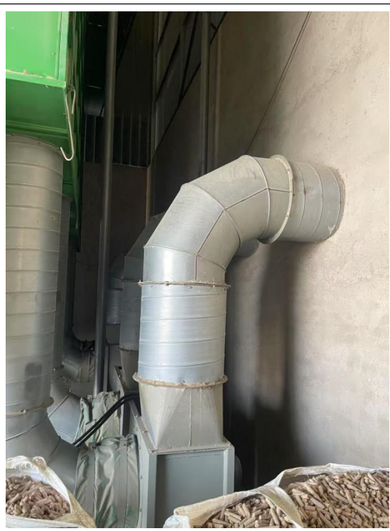
沉降室废气进口
